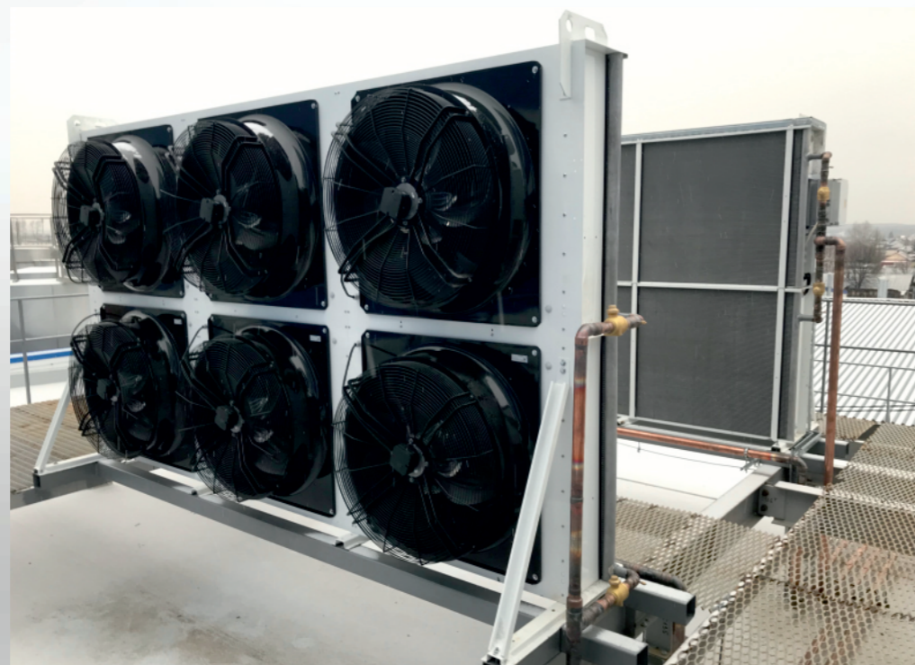
Ирбитский молочный завод Свердловская область. Конденсаторы 2 шт. Q =340 кВт каждый. 2017 г. Круглогодичное использование.
