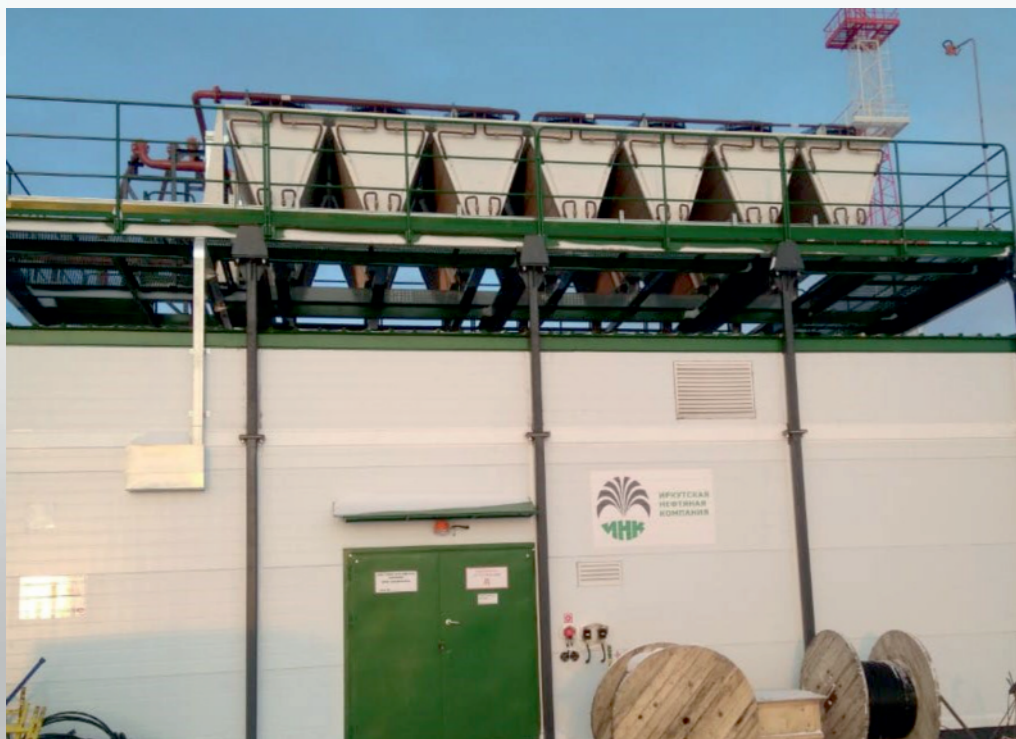
Иркутская Нефтяная Компания. Два конденсатора по 1200 кВт 2018 г. Нефтяное месторождение, круглогодичное использование в условиях крайнего севера. Охлаждение технологического оборудования.
